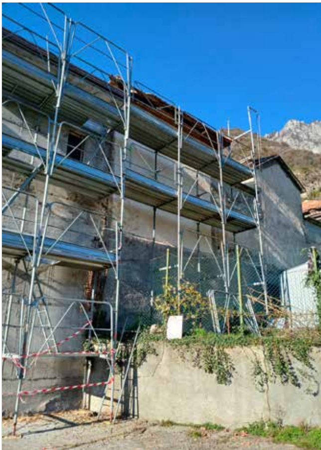
Sistemazione delle guaine di copertura al Cimitero di Terzano e alla Cappella Zana mettendo così in sicurezza il Cimitero.
